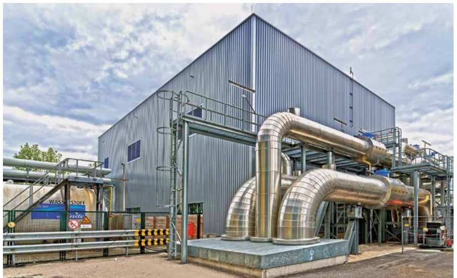
Am Vattenfall Standort Reuter West in Berlin Spandau ging 2019 Europas größte Power-to-Heat-Anlage in Betrieb.
